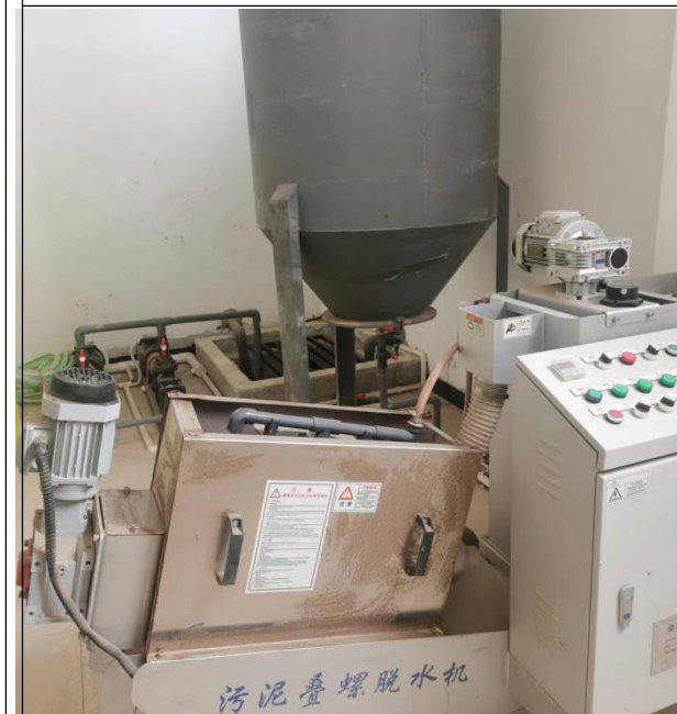
污水处理站污泥压滤机
