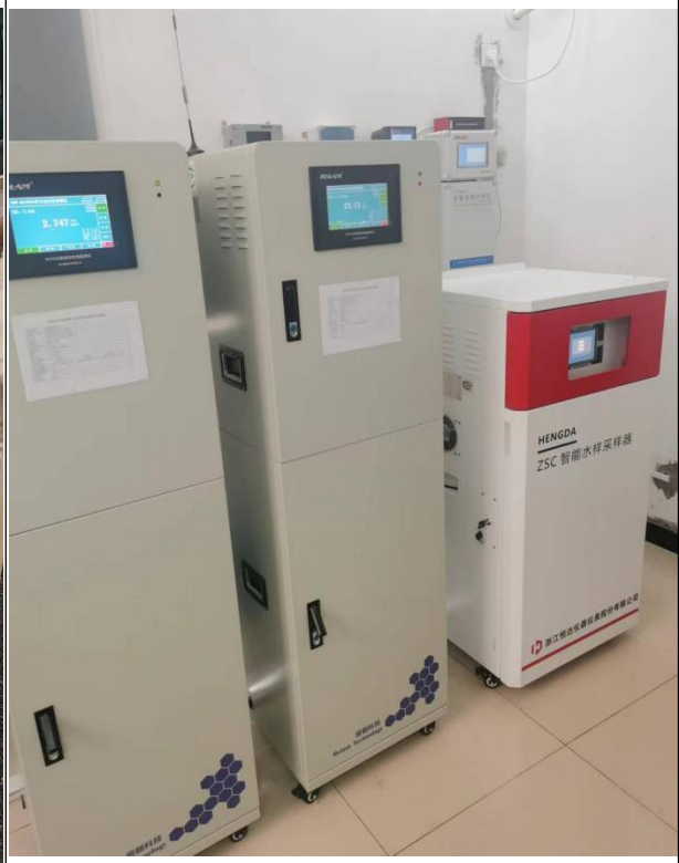
污水处理站在线监测设备
