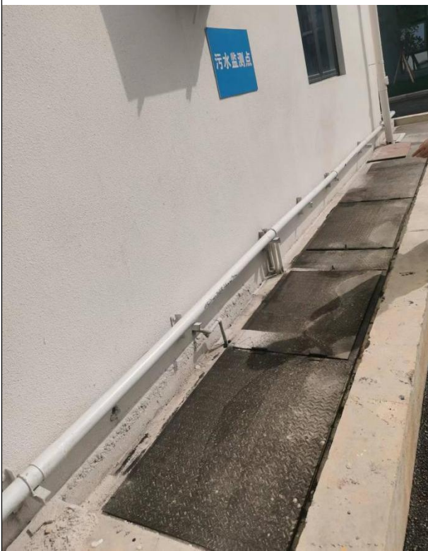
废水总排放口
