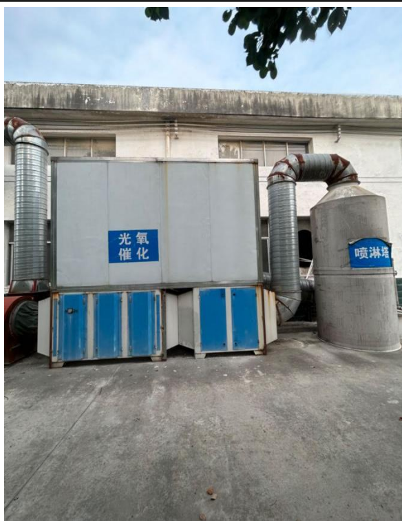
喷漆废气处理设备
