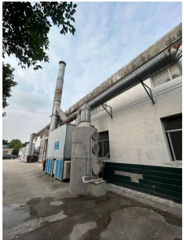
喷漆废气排气筒
